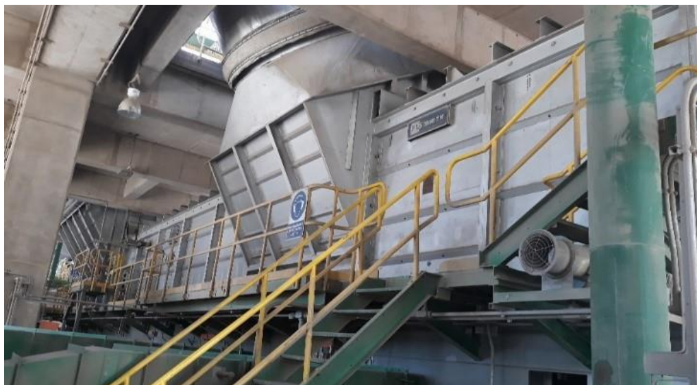
Figura 16 Enfriador de Clinker
