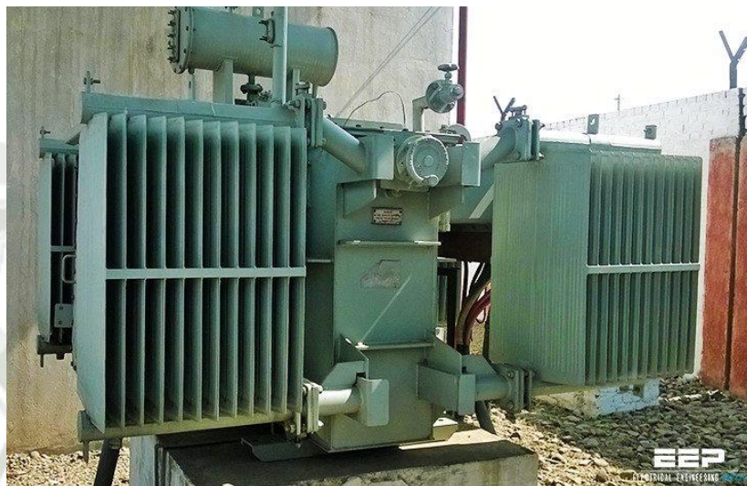
Figura 4: Transformador de Distribución
