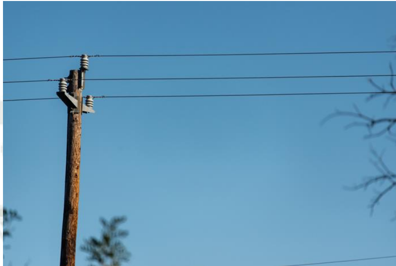
Figura 24: Poste de madera
