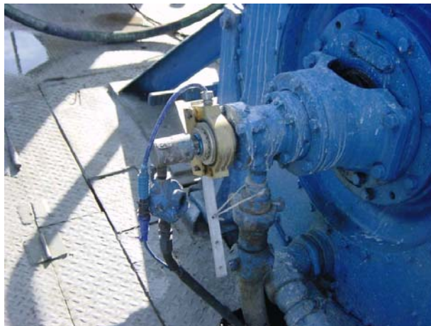
Figura 154. Sensor de Profundidad Instalado en el Malacate.
