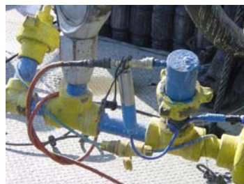
Figura 145. Sensor de Presión Instalado en Campo.
