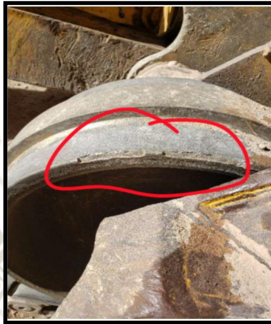
Figura 43: Fractura de bocina por junta seca.
