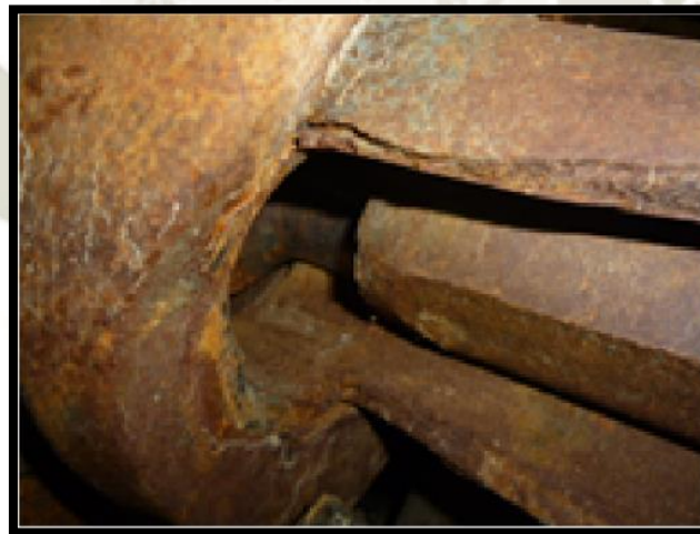
Figura 42: Fractura de bocina por junta seca.
