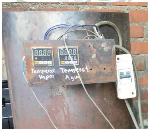
Ilustración 4: Panel de equipo de curado en autoclave
