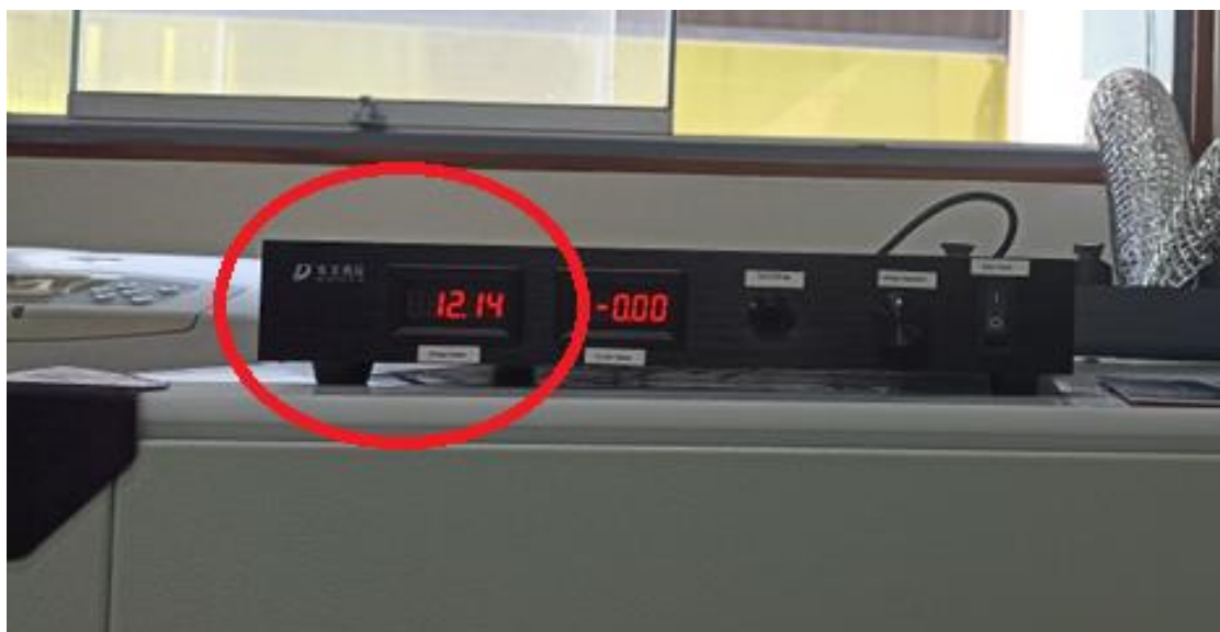
Figura 3.14 Graduación de voltaje en elevador de tensión
