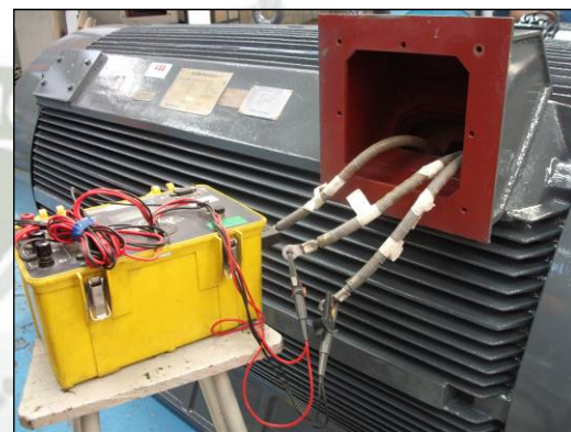
Fotografía N° 5.9.- Medida de Resistencia Óhmica - Después del Montaje.
