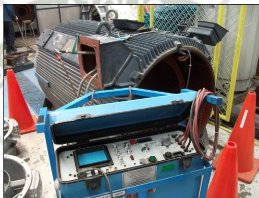
Fotografía N° 5.2.- Pruebas de HI-POT y Comparación de Pulsos con Equipo Baker - Después del Desmontaje.
