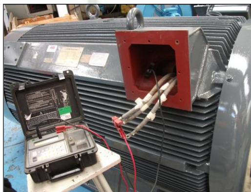
Fotografía N° 5.8.- Medida de Resistencia de Aislamiento - Después del Montaje.
