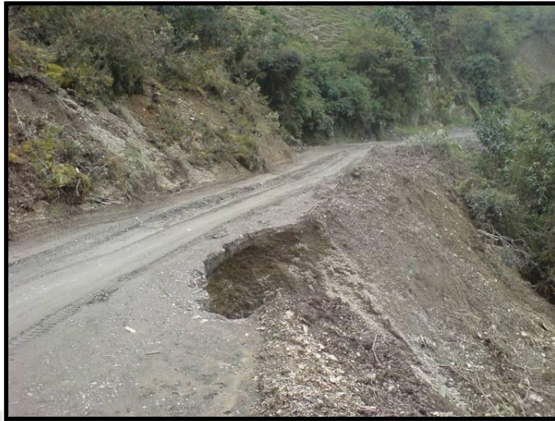
Figura 24. Vista de zona crítica Km.101+840, deterioro de plataforma.
