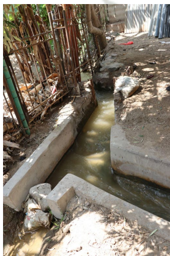
Compuerta deslizante del inicio del canal de regadío del fundo
