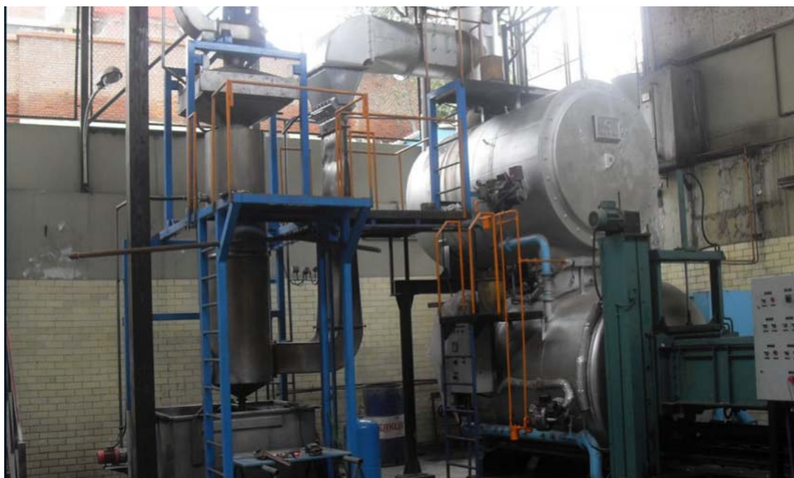
Fig. N° 9 Incinerador de Doble cámara, del Hospital Nacional Carlos A. Según Escobedo.
