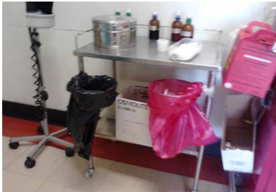
Fig. N° 1 Contenedor rígido de residuos punzo cortantes en riesgo de caída, bolsas negra y roja, sin contenedores para segregación de residuos sólidos.
