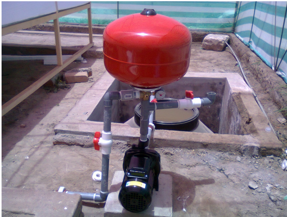
FOTOGRAFIA No. 13 Electro bomba y equipo hidroneumático
