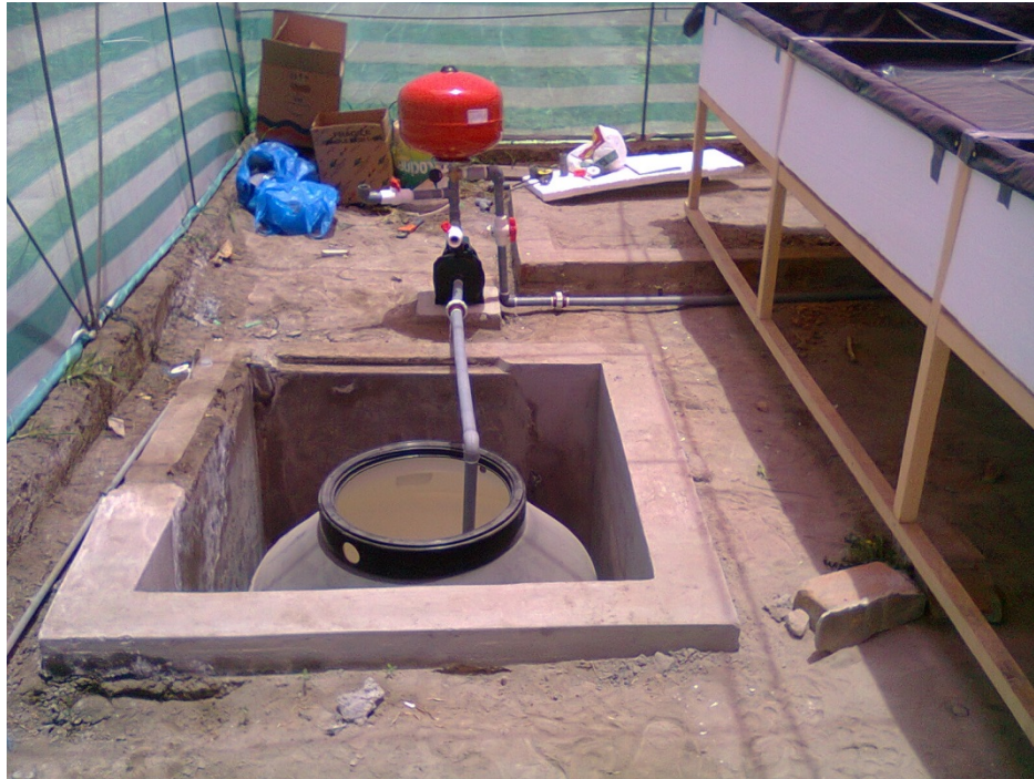
FOTOGRAFIA No. 14 Electrobomba, equipo hidroneumático y reservorio de agua
