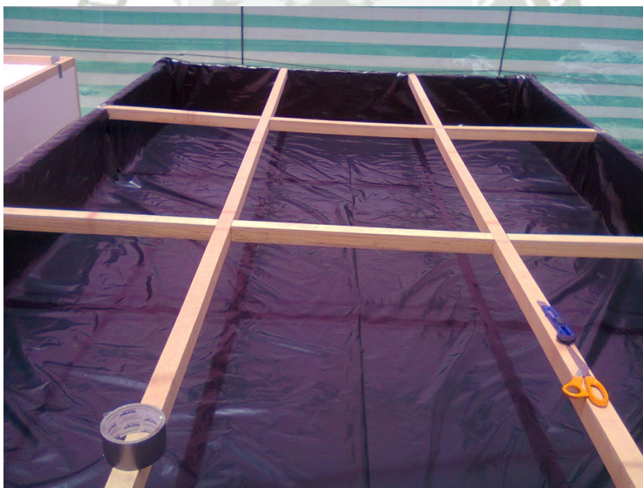
FOTOGRAFIA No. 11 Contenedor impermeabilizado y sistema de riego
