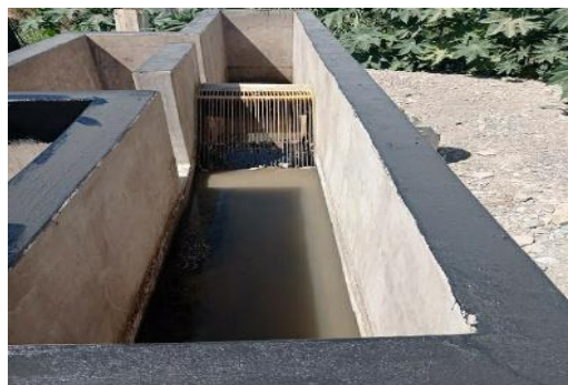
Figura 2. Cámara de rejillas
