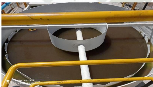
Figura 25. Sedimentador de lodos – agua tratada
