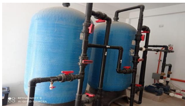
Figura 27. Filtro de arena y carbón activado
