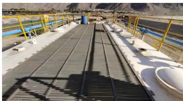
Figura 6. Tanques de aireación
