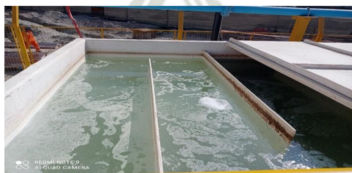
Figura 26. Cámara de contacto – desinfección del agua tratada
