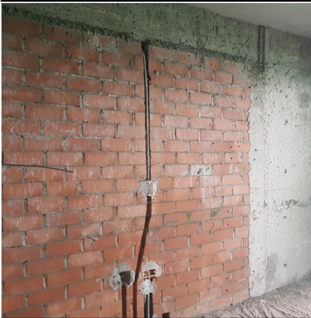
Instalación Eléctrica Fuente: Propia
