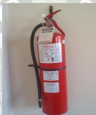
Figura N° 4: Extintor de los laboratorios de química
