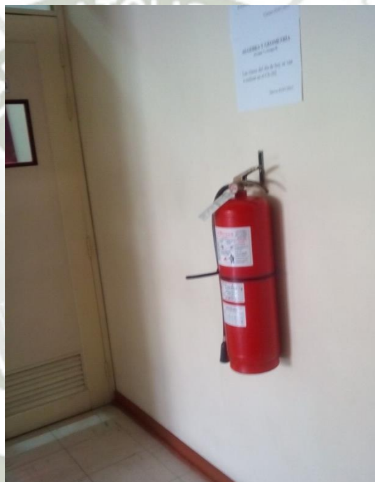
Figura N° 13: Extintor de los laboratorios teóricos de Ing. Industrial
