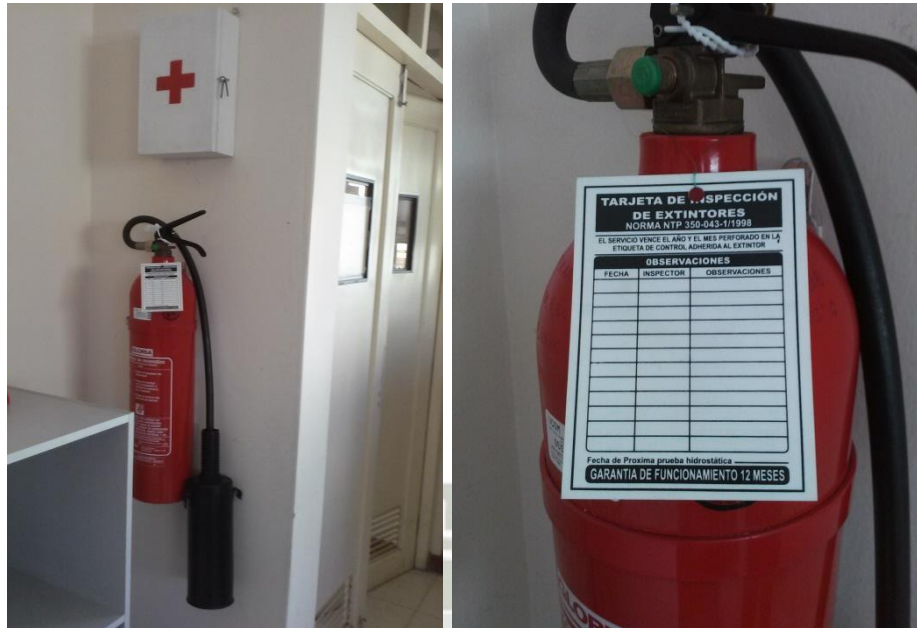
Figura N° 8: Condiciones de los extintores actuales
