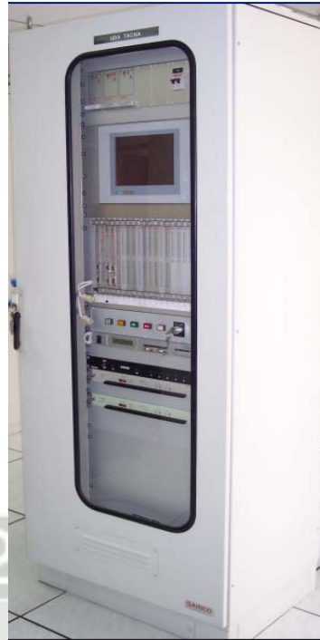
Figura 6-5. Foto de Unidad Terminal Remota (RTU).
