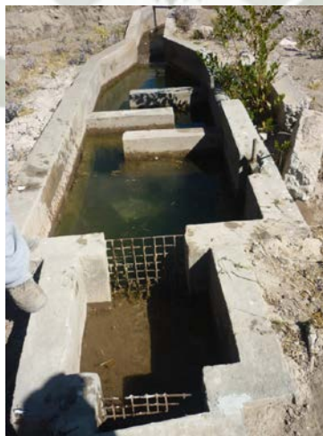
FOTOGRAFÍA 28. Canal de ingreso, desarenador, rejilla y tubo de ingreso (Sector Chipicpita)
