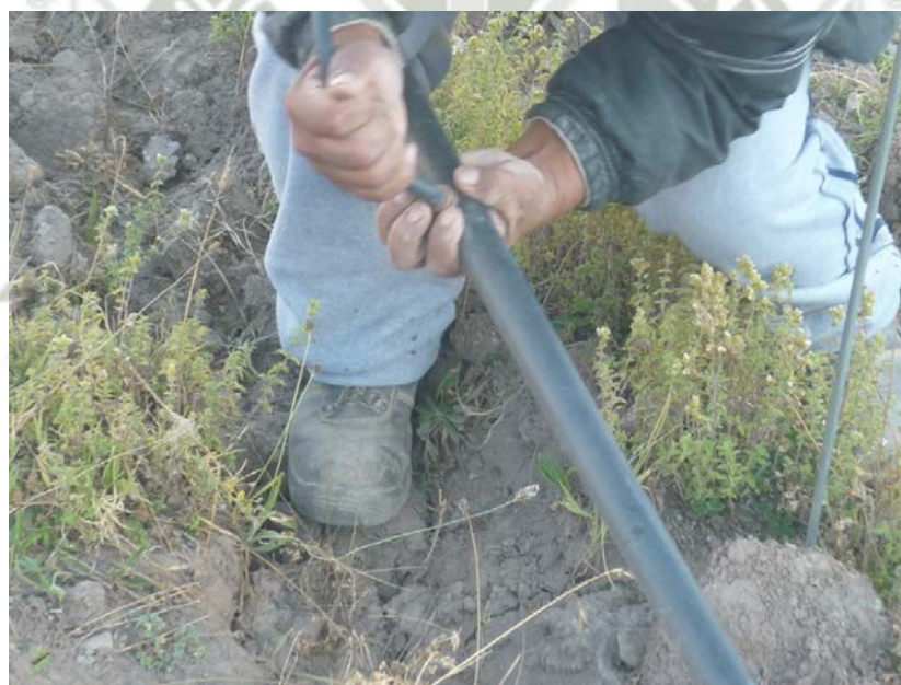
FOTOGRAFÍA 21. Instalación tubería PE Ø 25 mm, tubo conector de aspersor y conector inicial (Sector La Ponderosa)
