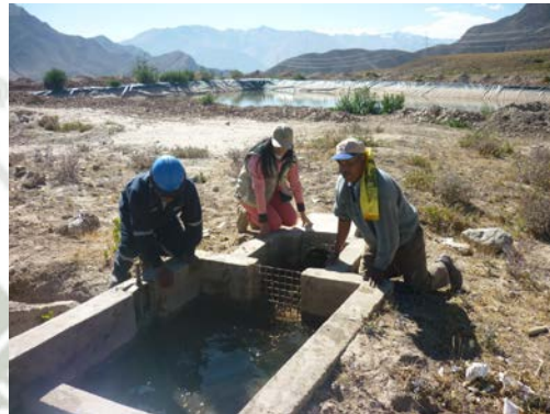
FOTOGRAFÍA 29. Desarenador, compuerta de limpia, rejilla y tubo de ingreso (Sector de Chipicpita)
