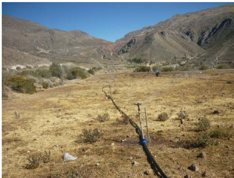
FOTOGRAFÍA 31. Línea lateral con tubería PEØ 32 mm. (Sector Chipicpita)
