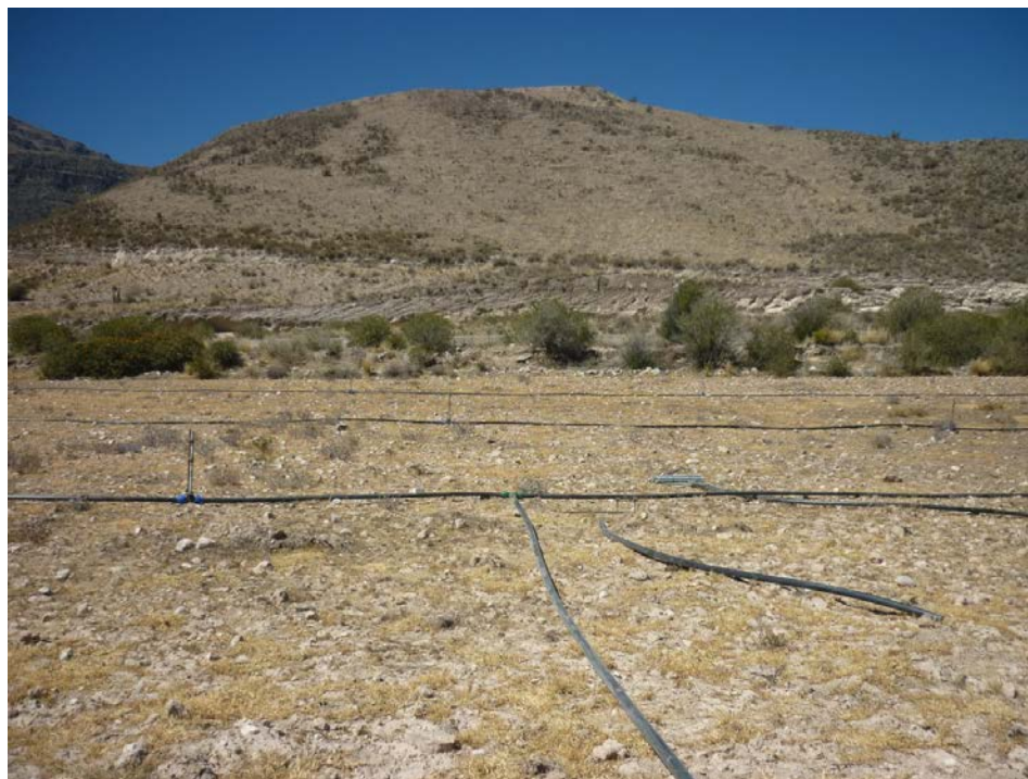
FOTOGRAFÍA 35. Líneas laterales P.E.Ø 32 mm instalados en campo (Chipicpita)
