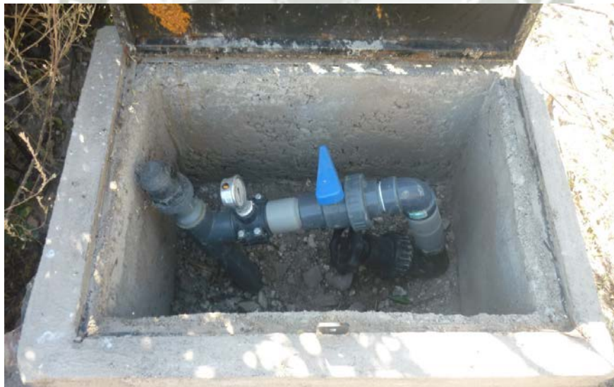
FOTOGRAFÍA 05. Caja de protección de válvulas con tapa metálica (Sector Abrampampa)
