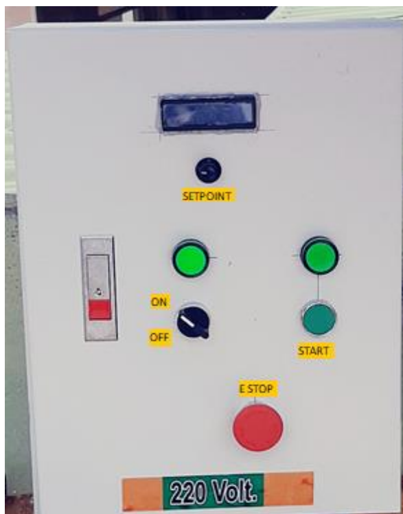
Fig. 66 Vista exterior del panel de control, Fuente: Elaboración propia
