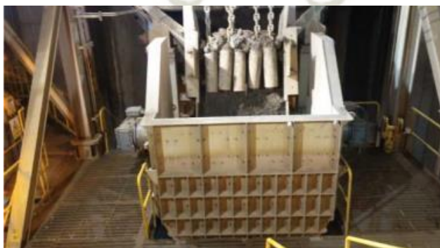
Figura 25. Retenedores de Carga. Fuente: Elaboración propia.
