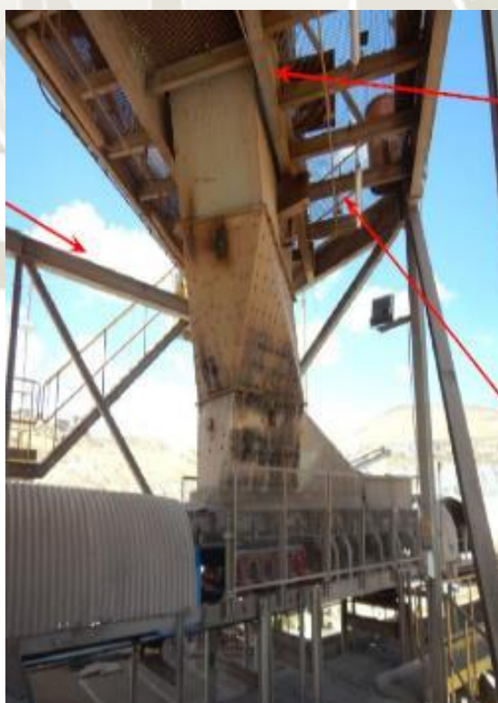
Figura 18. Chute en Minería. Fuente: Dismet (2012).
