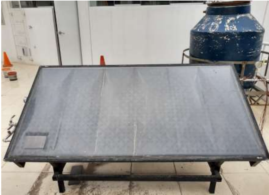
Figura 28: Colector solar instalado (Vista Frontal) Fuente: Propia
