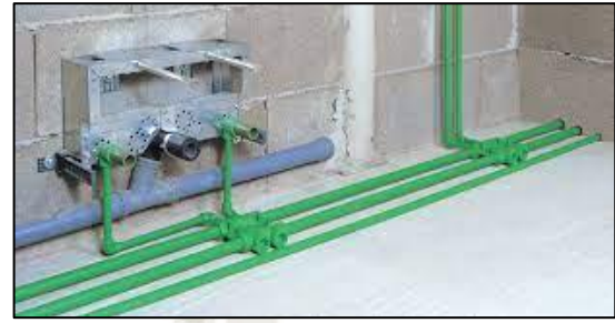
Figura 89: Sistema de Tuberías de Polipropileno
