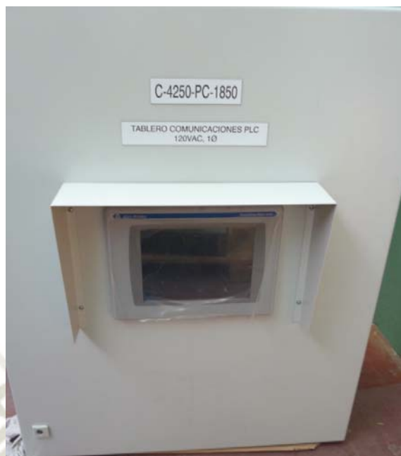
Figura N°33. Vista general de tablero de comunicación C-4250-PC-1850
