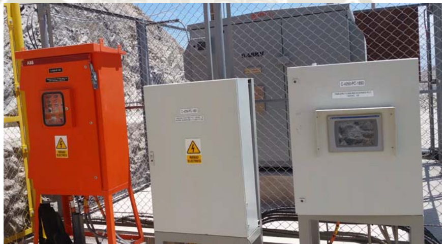
Figura N°85. Tablero de fuerza (VFD), tablero de control y comunicaciones en ubicación de pozo MT1
