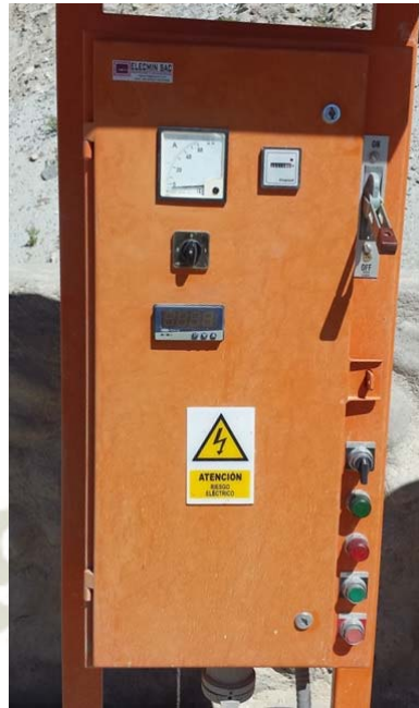
Figura N°84. Tablero de control antiguo
