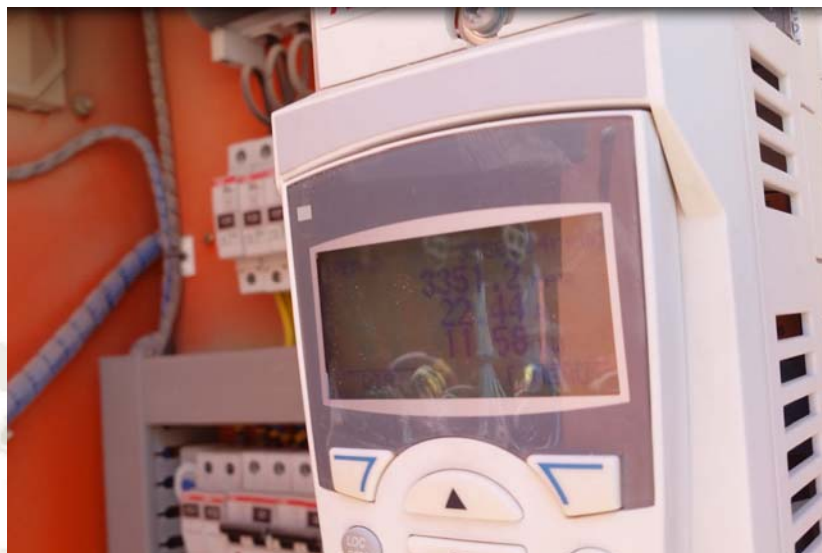
Figura N°86. Variador funcionando a 3351.2 RPM
