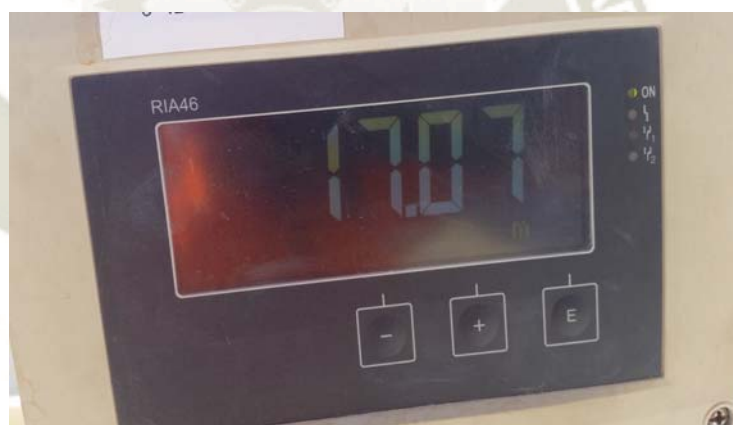
Figura N°89. Transmisor de nivel ubicado en pozo MT1
