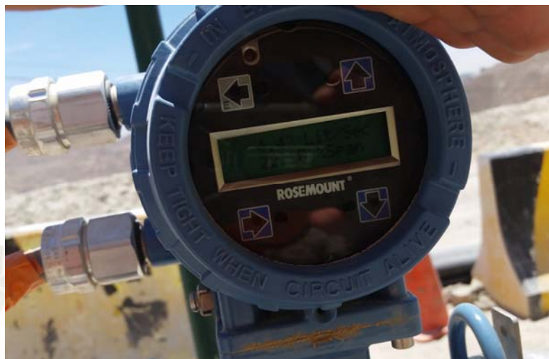
Figura N°90. Transmisor de flujo ubicado en pozo MT1
