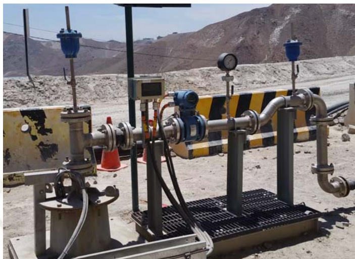
Figura N°88. Sistema de bombeo
