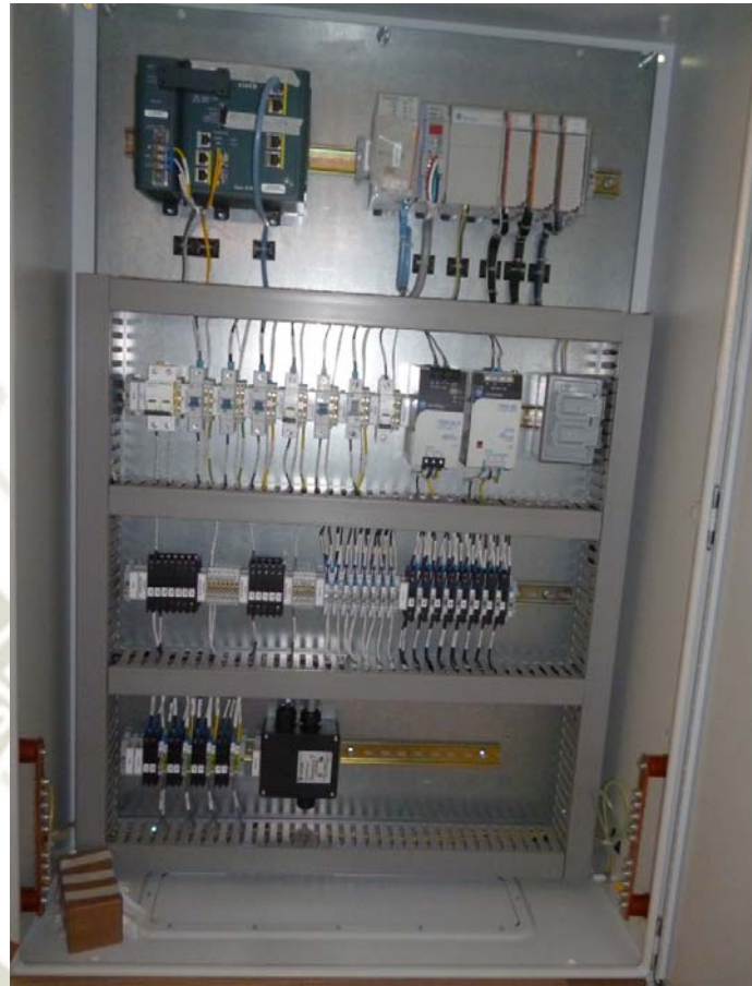
Figura N°37. Vista interna de tablero de control, distribución de equipos
