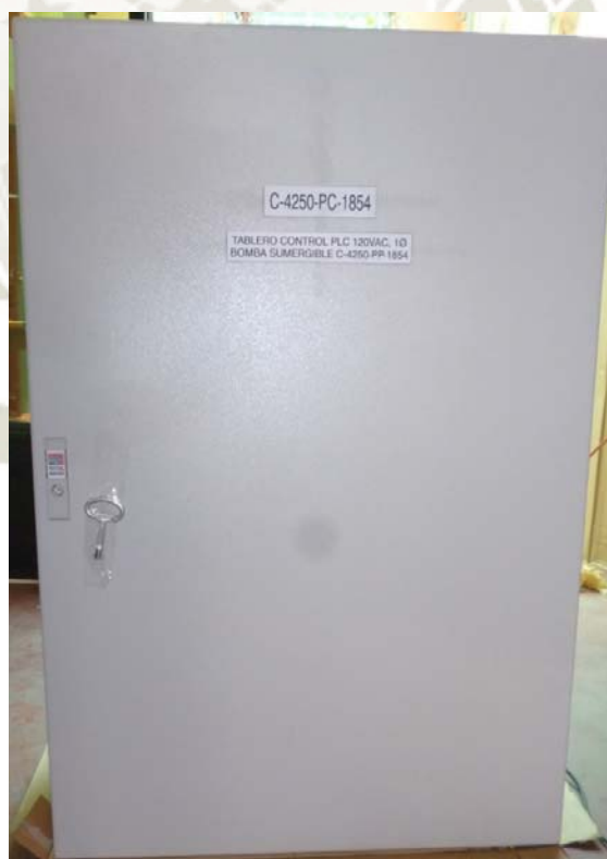
Figura N°36. Vista general de tableros de control
