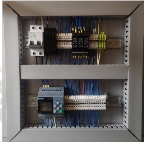
Figura 4.2 Tablero de control implementado
