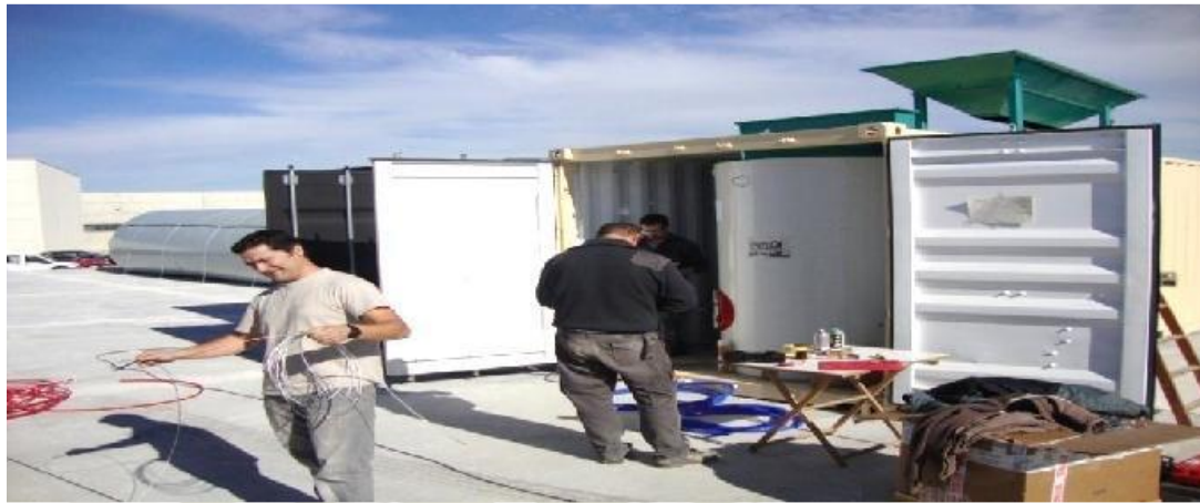
Figura 8: Equipamiento e instalación del biodigestor Empresa Ecoalia en Burgos – España donde se presentó el biodigestor que vino hacia Arequipa. (Instalado en dos contenedores).
