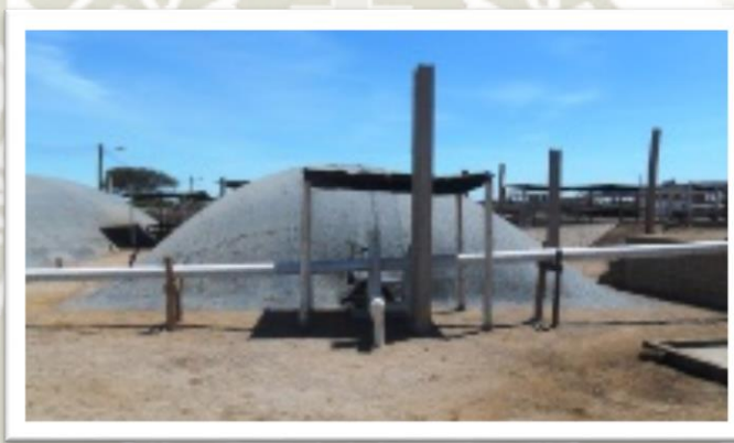
Figura 1: Uso de biogás en Fundo América
