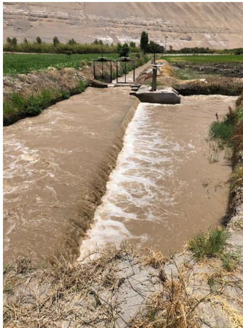
Observamos la estructura de derivacion de forma deficiente en situ
