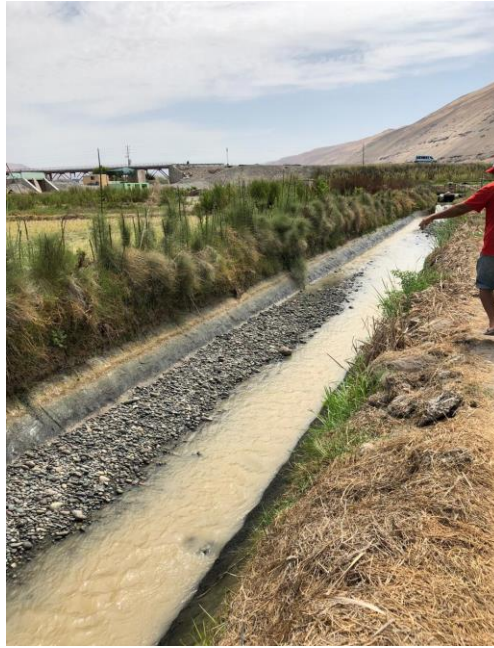
Observamos el canal sin mantenimiento
