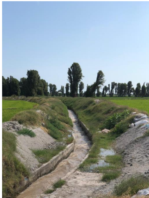
Observamos la presencia de arena perteneciente a la colmatacion del canal
