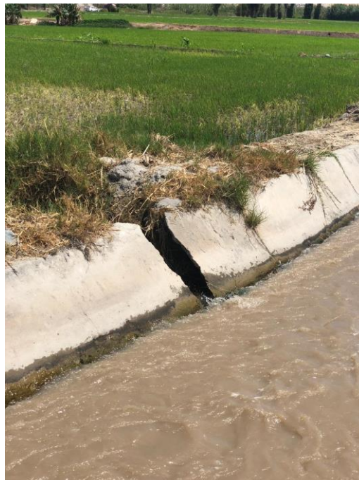
Observamos danos en las paredes del canal
