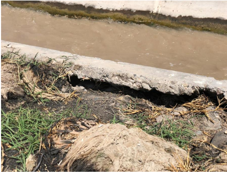
Observamos los problemas que tiene el canal en situ
