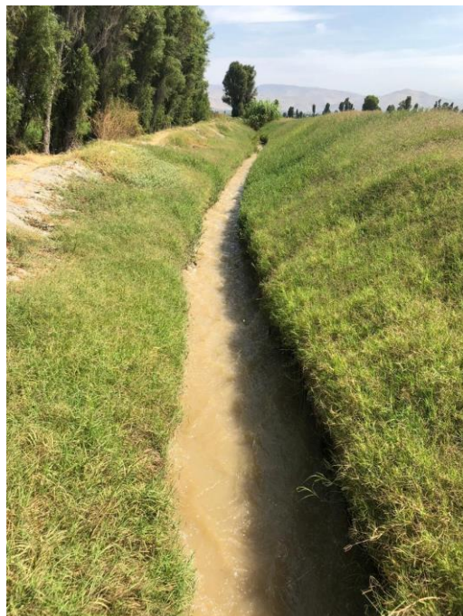
Observamos la presencia de arbusto en el canal
