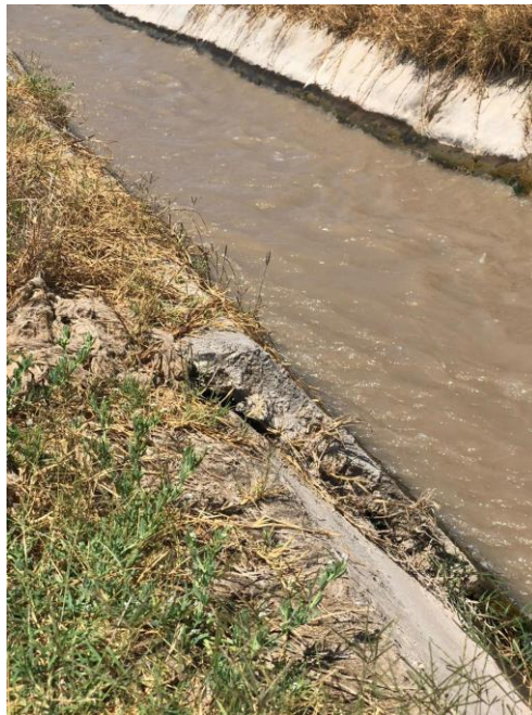
Observamos el pared lateral del canal danada
