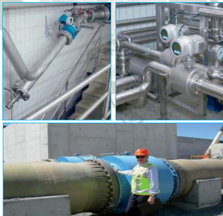
FIGURA Nº 26: CAUDALIMETRO ELECTROMAGNETICO PUESTA EN MARCHA
