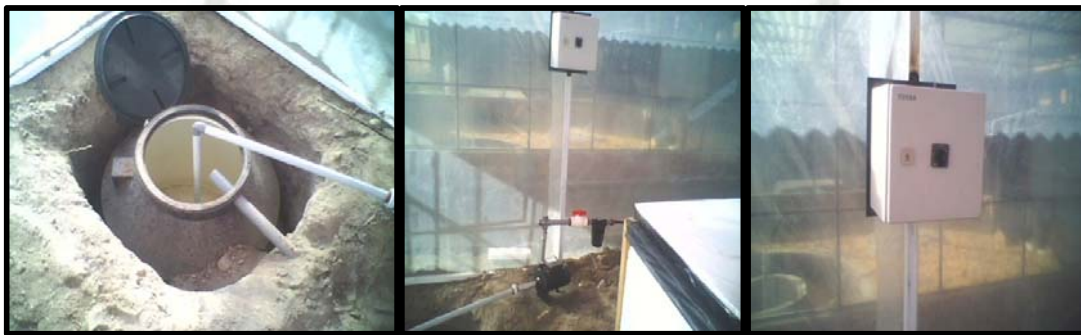
Fotografía 11: Instalaciones eléctricas y de gasfitería.
