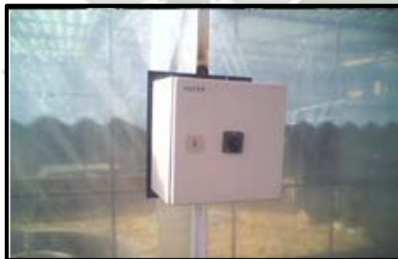
Fotografía 18: Panel de control de riego.
