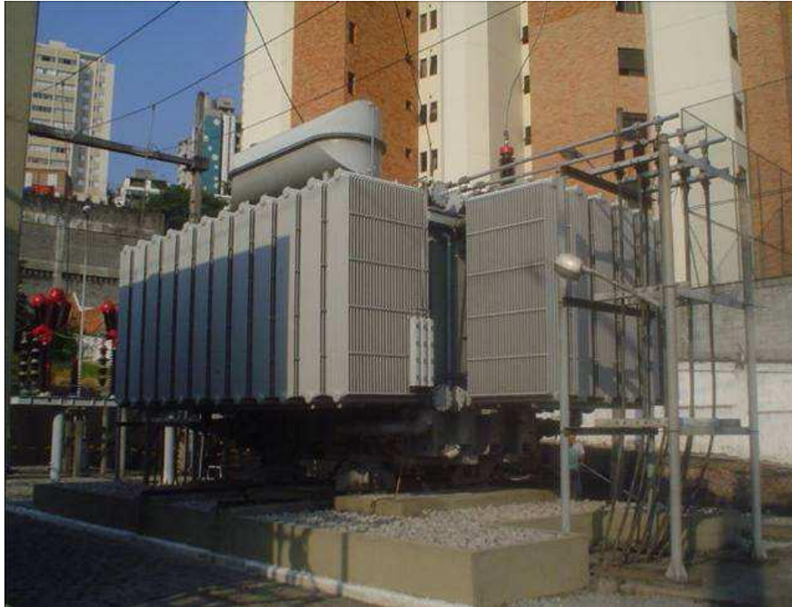
Figura 3.1: Transformador regulador de potencia 30/40 MVA, 138-13.8/11.95 kV
