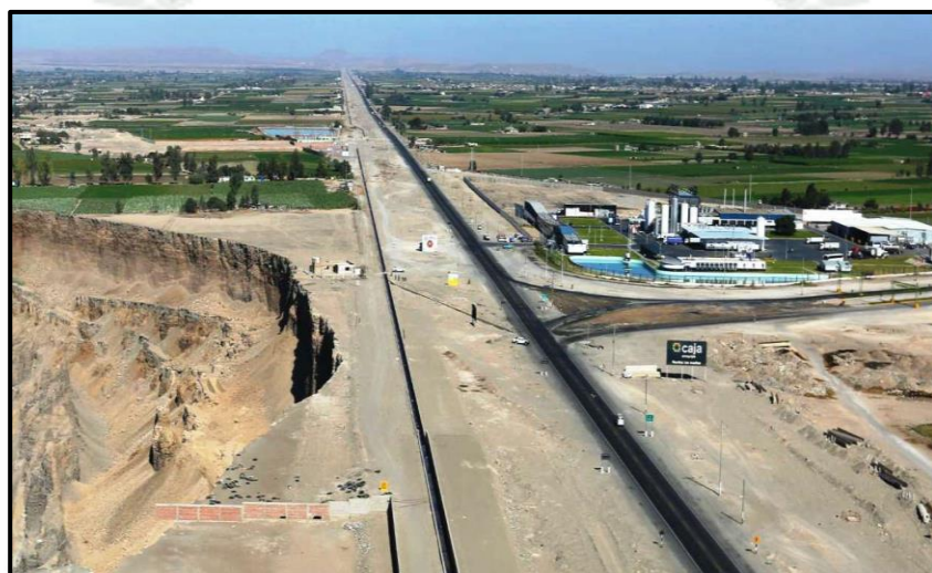
Figura 19: Carretera dañada en el valle de Sigas
