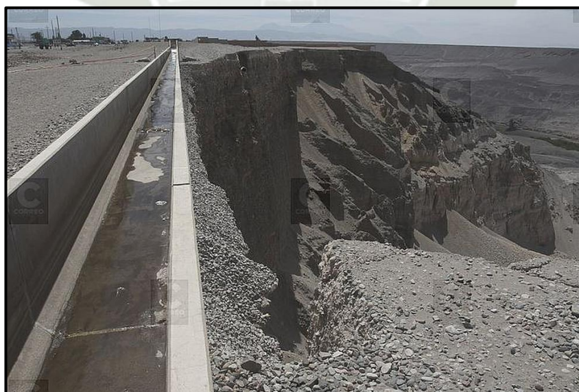
Figura 18: Infraestructura de riego dañada en el valle de Sigwas
