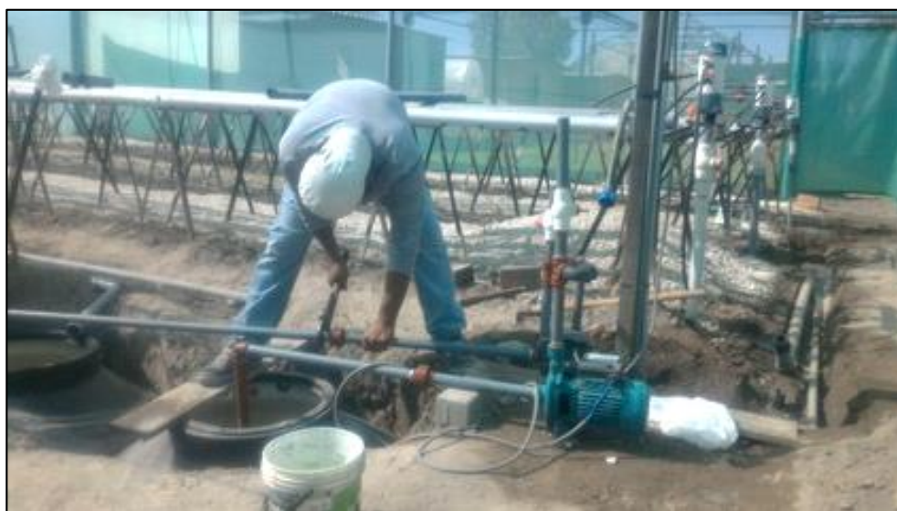
Fotografía N° 15: Individualización de la tubería de ambas Bombas Eléctricas
