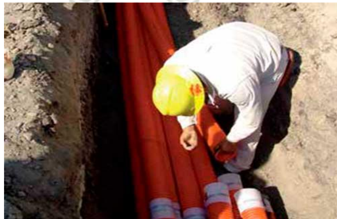
Figura 12. Bancos de ductos.
