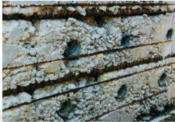
Foto 8: Una consolidación pobre de concreto
