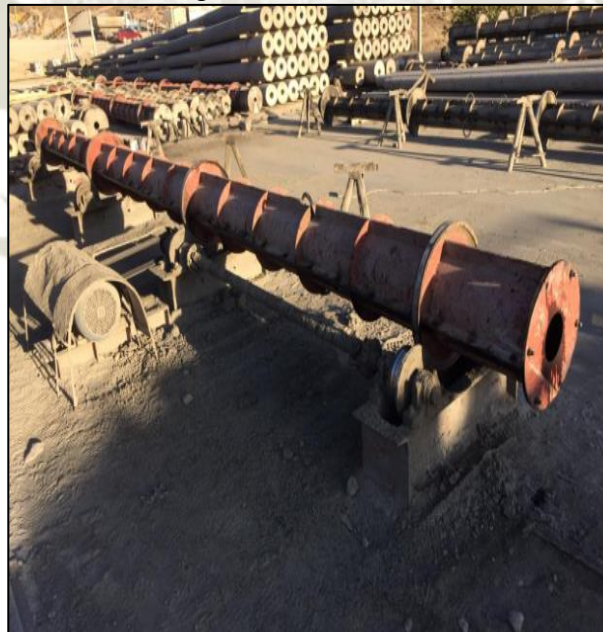
Imagen 79: Centrifugadora con variador de frecuencia
