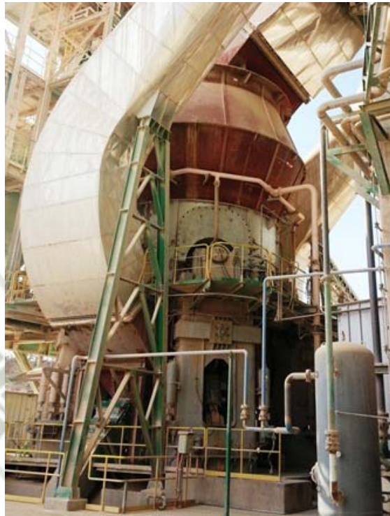
Imagen A12: Molino vertical de crudos y ducto de alimentación al intercambiador
