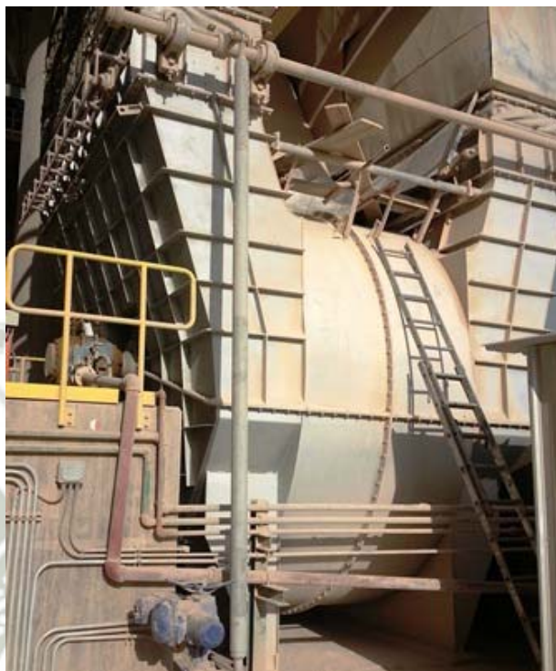
Imagen A14: Ventilador ID fan
