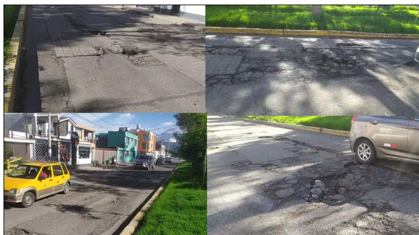
Imagen 46: Estado actual de la calzada de salida de la Av. Perú
