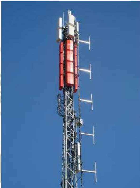
Figura 104 Torre soportante y arreglos de antenas UHF
