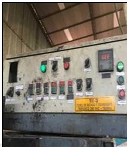
Figura 73: Rotulado de Control de Mando
