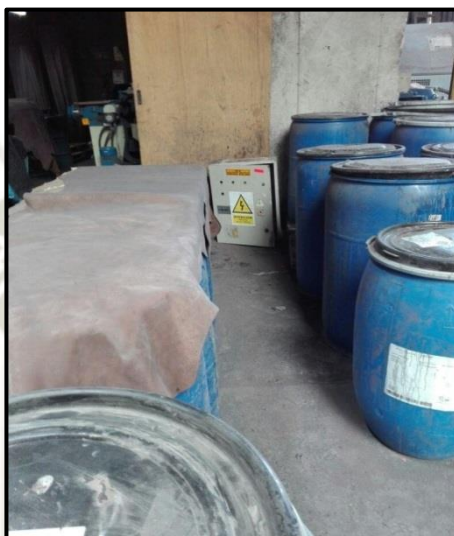
Figura 48: Caja eléctrica descompuesta
