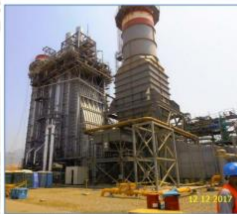
Figura 05: Caldera de recuperación de Calor y Chimenea
