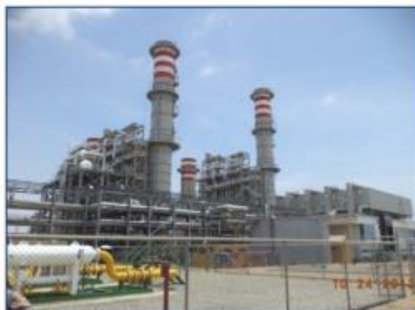
Figura 02: Calderos recuperadores de calor y chimeneas
