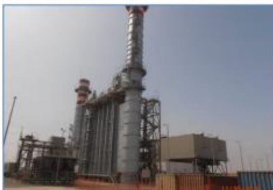
Figura 04: Vista de la CT Chilca 2
