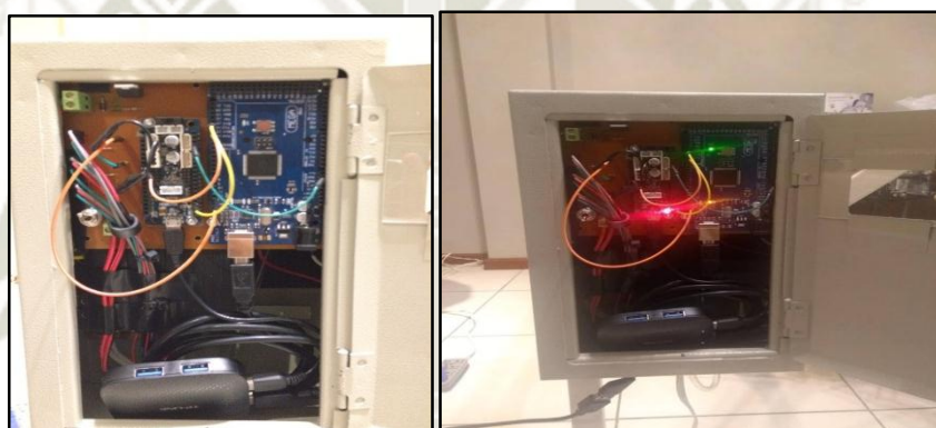
Figura 6.14. Tablero de Control Implementado
