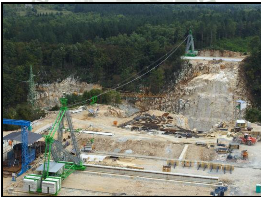
Ilustración 3-22 Blondin o grúa de cable
