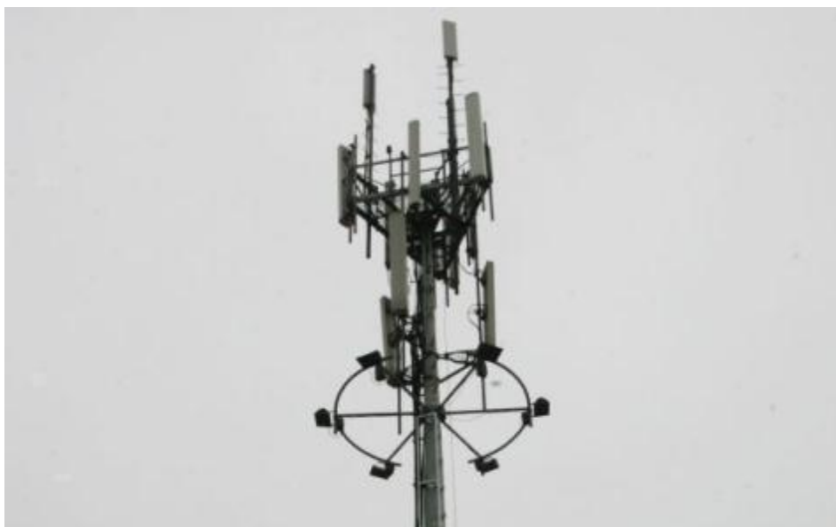
Fig. 2.8 Sobre las mismas torres 3G se instalan las 4G
