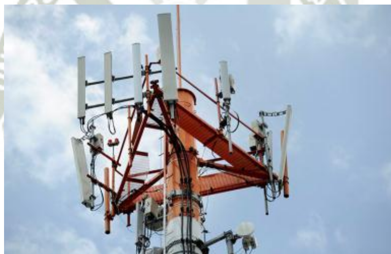
Fig. 3.6 Torres con Antenas 4G LTE
