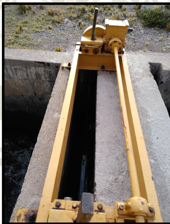
Figura 98. Compuerta de amortiguamiento N°3 parcialmente abierta. Fuente: Figura elaborada por el autor, 2019
