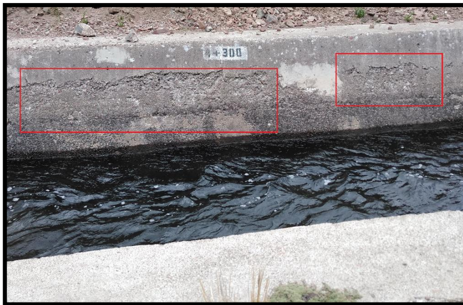
Figura 113. Detalle del deterioro del canal. Fuente: Figura elaborada por el autor, 2019.
