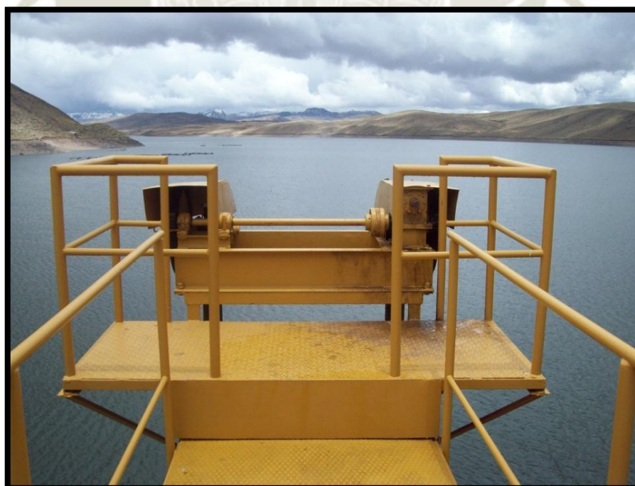
Figura 21. Instrumentación para el izaje de las Compuertas de descarga de Fondo de la Represa El Pañe.
