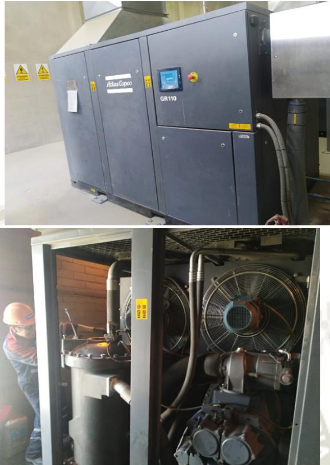
Figura 2.9. Compresor Altas Copco de alta presión para Filtros Larox, Toquepala Fuente: Elaboración propia
