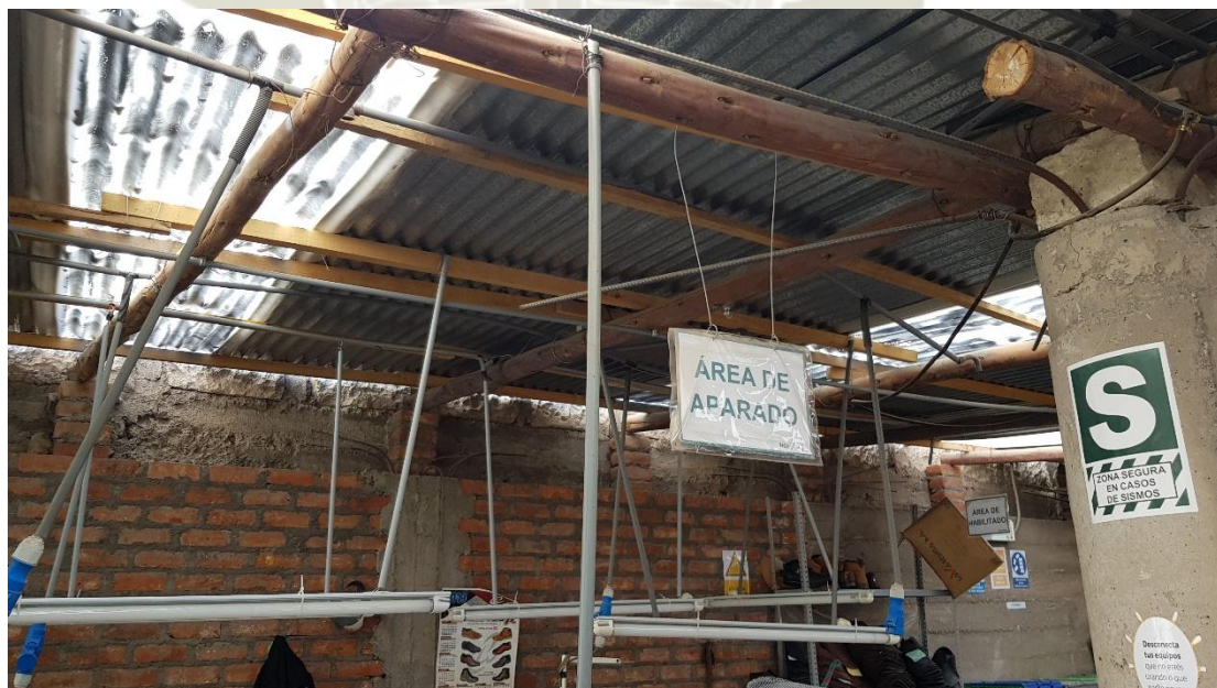
Figura 40: Señalización para zona segura contra sismos
