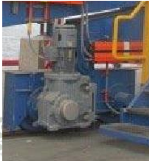
Fotografía 3.3: Motoredutores de Travel
