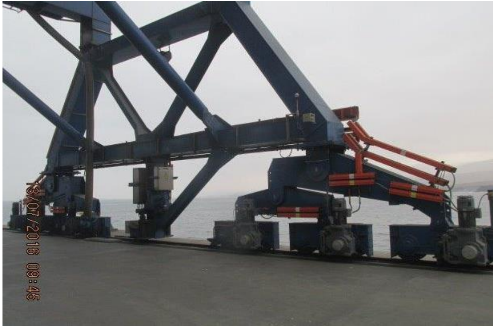
Fotografía 3.2: Sistema de Recorrido del Shiploader (Fuente: Área de Mantenimiento, Tisur - Ingeniería)
