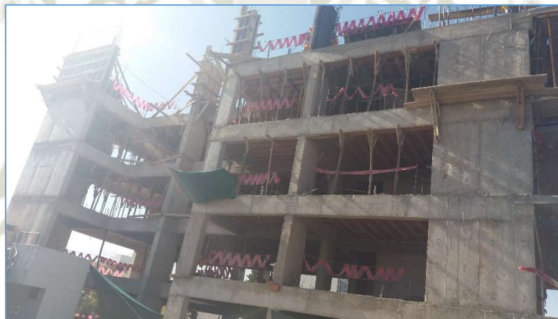
Figura 61: Defectos en el vaciado de concreto en obra, Obra Residencial Palermo (Fuente: Propia)
