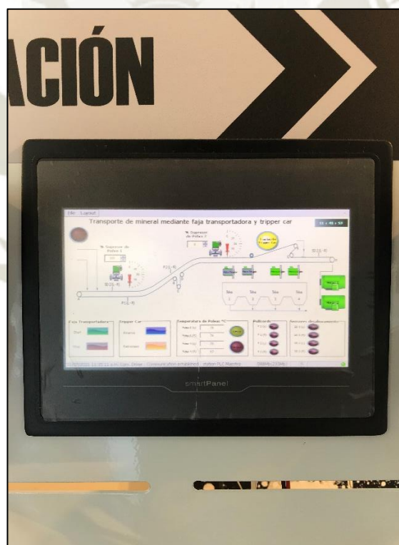
Figura 78. Smart Panel TP307-SM VIPA del módulo de automatización en operación.
