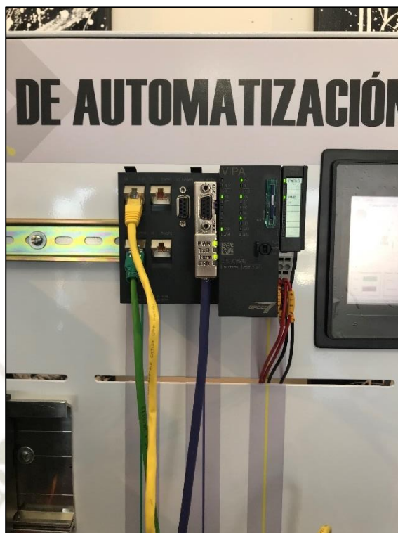
Figura 77. CPU 015PN SLIO del módulo de automatización en operación.
