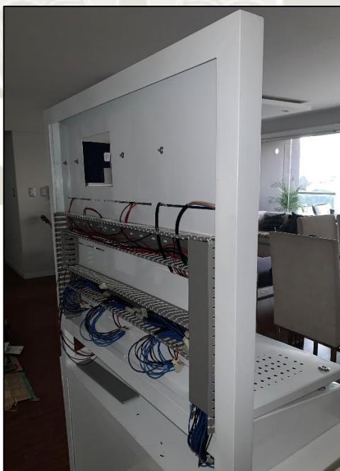
Figura 70. Cableado de equipos: Maestro PLC y unidades I/O esclavos en el módulo portante
