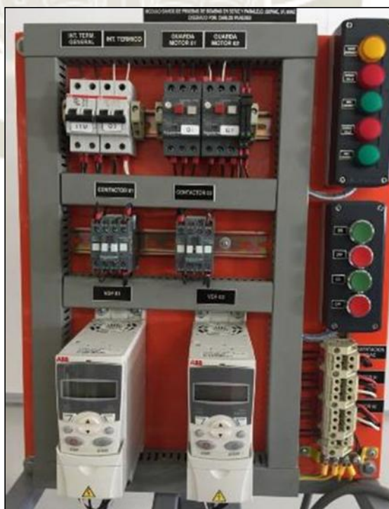
Figura 34. Tablero eléctrico del banco de pruebas (Fuente: foto real tomada del banco de pruebas)
