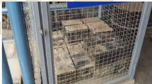
Foto 1. Baterías en desuso
