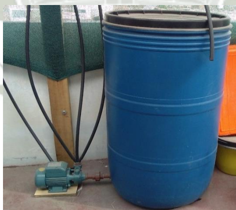
Fotografía 14. Cilindro con electrobomba
