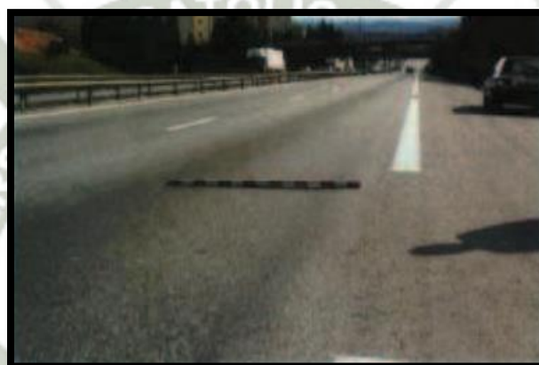
Ilustración 5 Falla estructural: Ahuellamiento, tomada del Manual de Carreteras “Mantenimiento o Conservación Vial”, 2014
