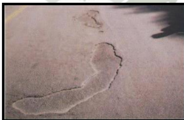
Ilustración 6 Falla Superficial: Peladura y desprendimiento, tomada del Manual de Carreteras “Mantenimiento o Conservación Vial”, 2014
