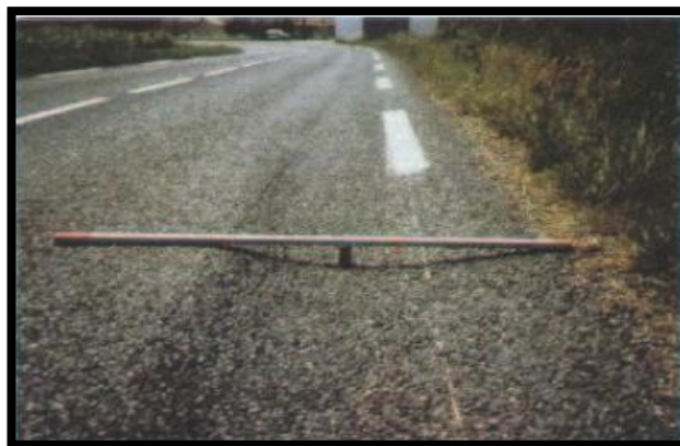
Ilustración 4 Falla estructural: Deformaciones, tomada del Manual de Carreteras “Mantenimiento o Conservación Vial”, 2014
