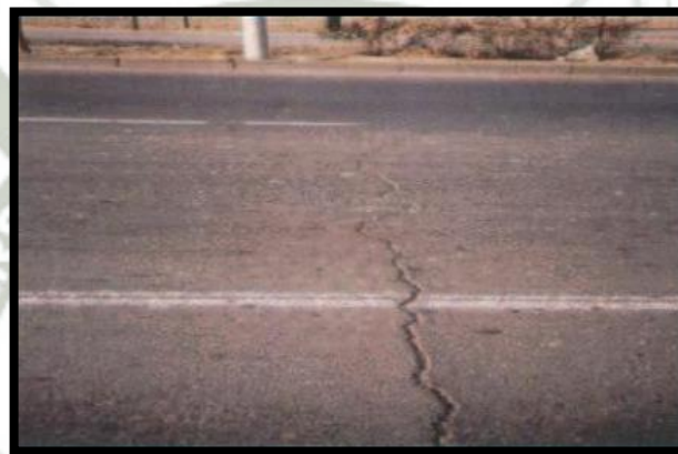
Ilustración 8 Falla Superficial: Fisuras Transversales, tomada del Manual de Carreteras "Mantenimiento o Conservación Vial", 2014
