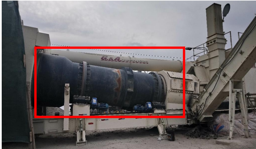
Figura 5: Secador de agregados, Fuente: Planta GyA contratistas, Arequipa (2019)
