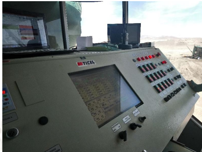
Figura 16: Sistema de control, Fuente: Planta Marquisa SAC (2019)
