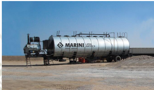
Figura 32: Sistema de almacenamiento de combustible, Fuente: Tanques de almacenamiento MARINI (2019)
