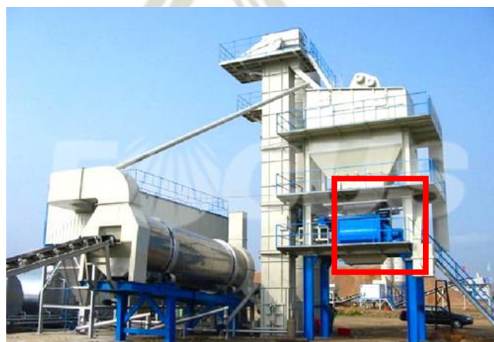
Figura 8: Silo de almacenamiento, Fuente: Manual de planta de asfalto FOCUS (2019)
