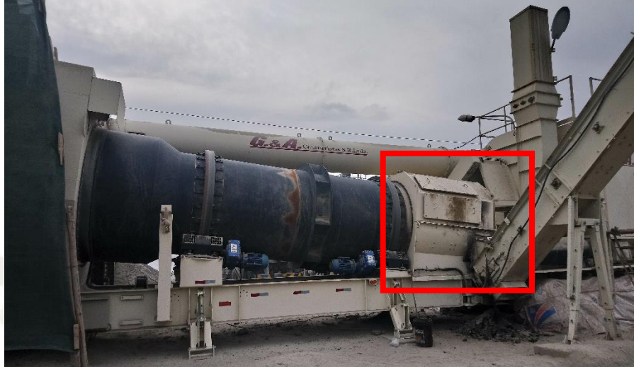
Figura 13: Mezclador, Fuente: Planta GyA contratistas (2019)
