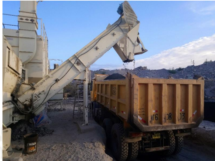
Figura 18: Transportador escalonado y silo de almacenamiento, Fuente: Planta GyA contratistas (2019)
