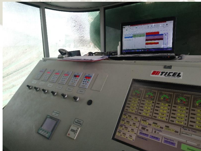
Figura 15: Sistema de control, Fuente: Planta Marquisa SAC (2019)
