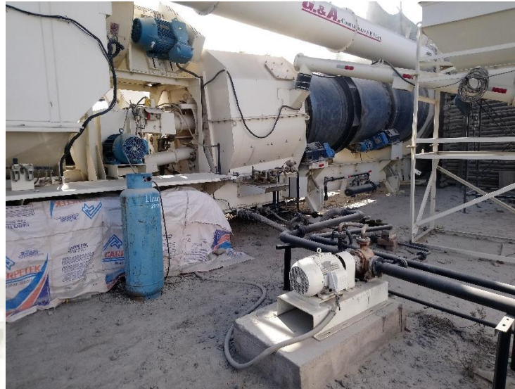
Figura 12: Dosificador de Cemento Asfáltico, Fuente: Planta GyA contratistas (2019)
