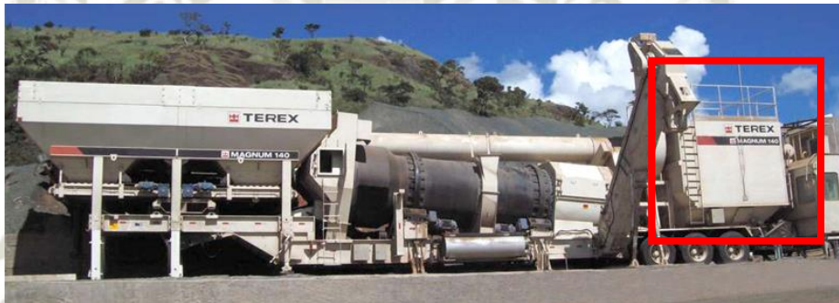
Figura 6: Sistemas colectores de polvo, Fuente: Manual de planta TEREX (2018)
