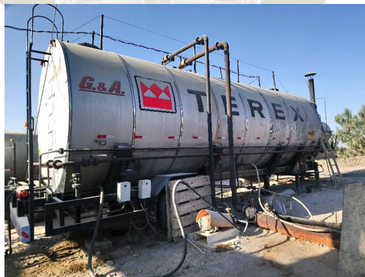
Figura 10: Tanque de almacenamiento, Fuente: Planta GyA contratistas (2019)
